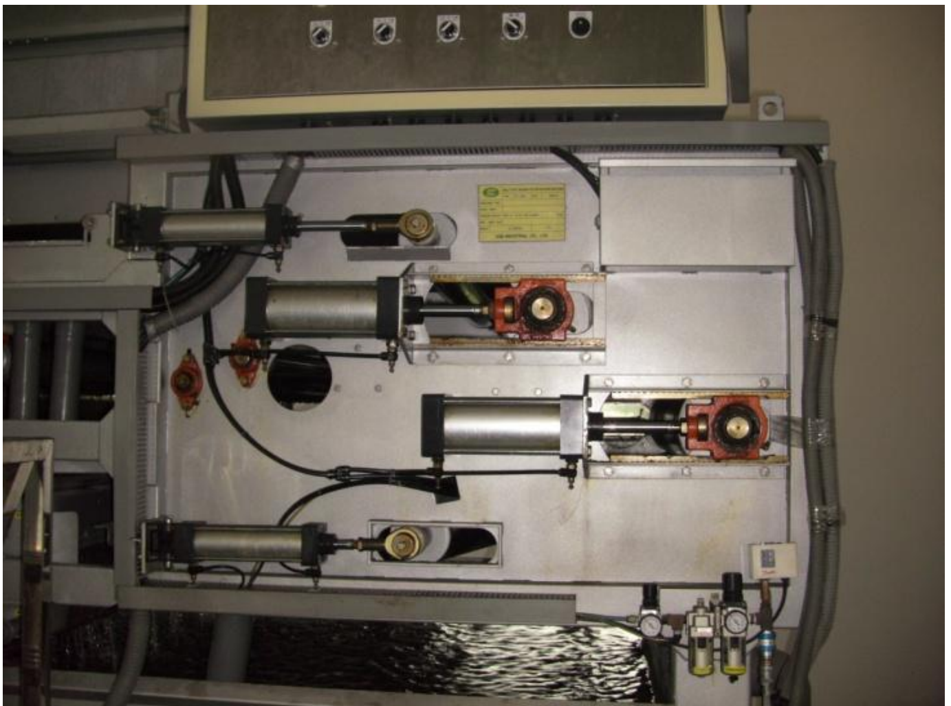
Рис.31. Устройство корректировки натяжения ленты.
