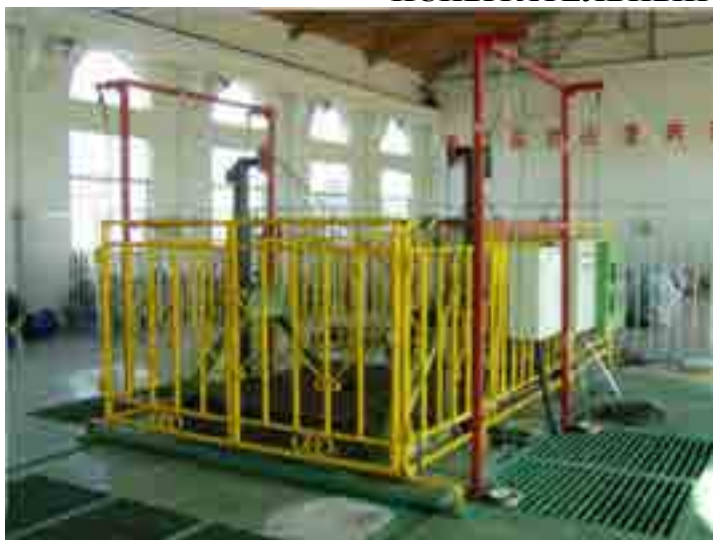
Рис.9. Аэрационная стендовая установка.
