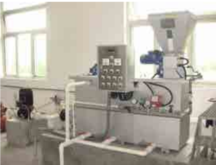
Рис.35. Трехкамерная станция приготовления флокулянта.
