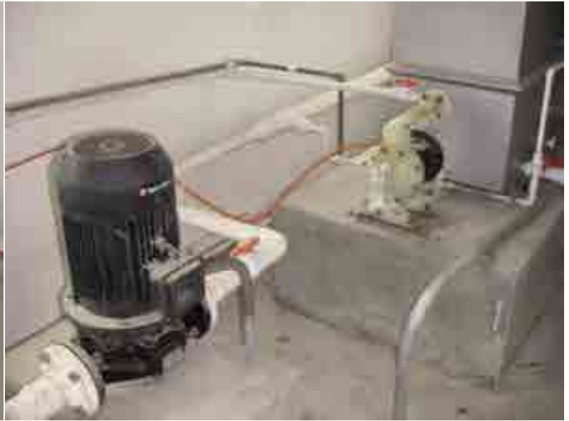
Рис. 37. Слева насос подачи воды на промывку, справа пневматический насос.
